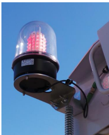
Afb. 10-14 Vliegobstakel baken in bedrijf
